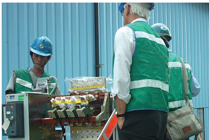
Prueba de cortocircuito sobre el terreno mediante un dispositivo de cortocircuito instalado en un carro
