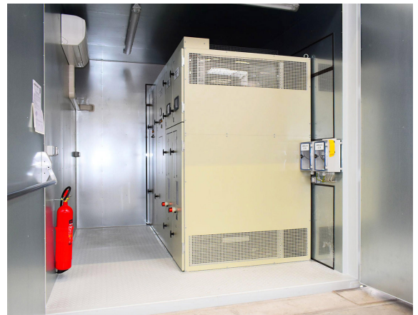
Cont. eléctrico equipado con MBS
